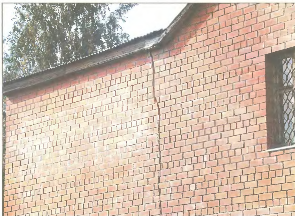
Причина появления таких трещин в стенах – незаглубленный или мелкозаглубленный фундамент и слабое армирование самих стен
