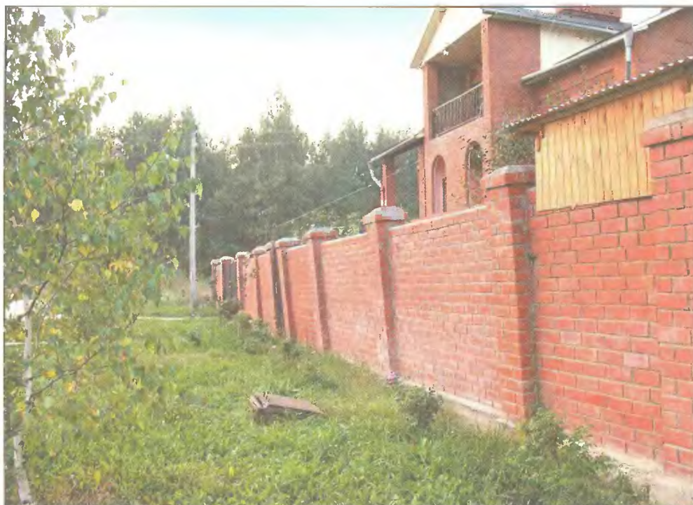
Ограда "завалена" из-за неглубокого заложения опор фундамента или из-за слабого их армирования
