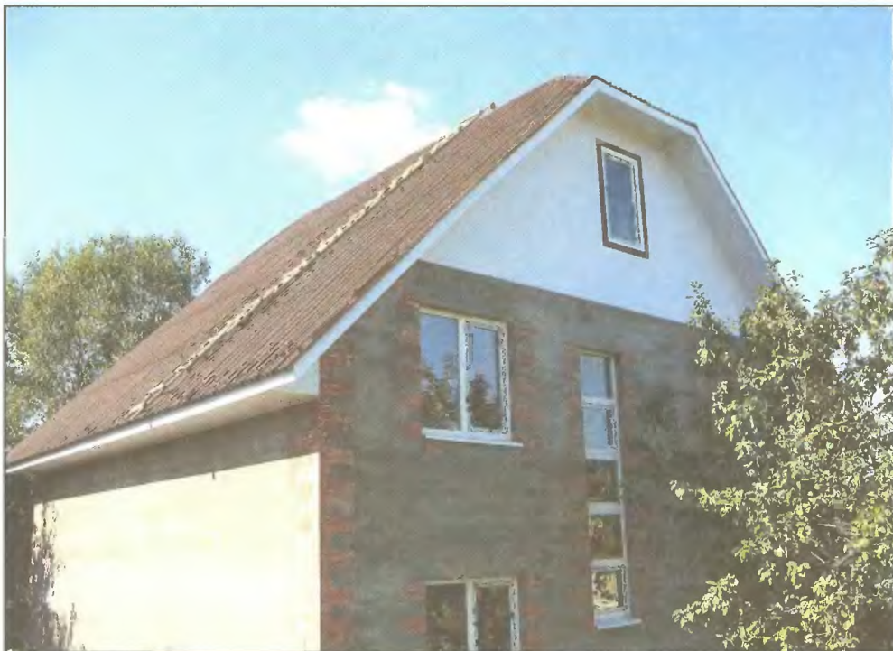
Дом (9х9 м) в Жаворонках (Подмосковье). Фундамент столбчато-ленточный с шагом опор около 1,4 м; стены трехслойные с ТИСЭ-3; перекрытия деревянные
