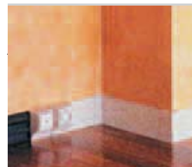
Электропроводка в плинтусе из ПВХ.
